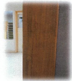
シロアリ被害にあった柱
