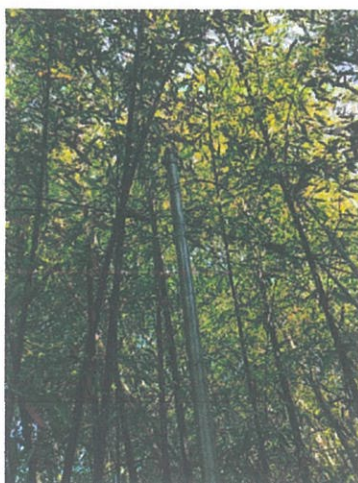
若宮坂 防犯灯N138 電線に竹接触（5/30 町へ依頼）
