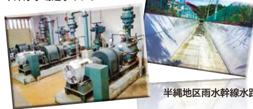
中津浄水場送水ポンプ
