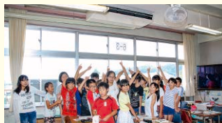
H28:小・中学校の普通教室にエアコンを設置
