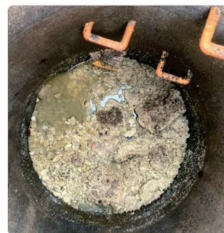
油脂類で閉塞したマンホール
