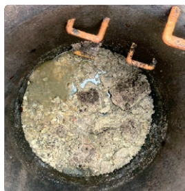
油脂類で閉塞したマンホール
