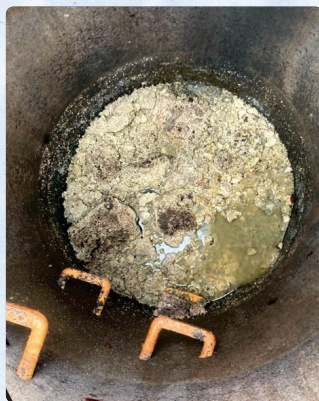
油脂類で閉塞したマンホール
