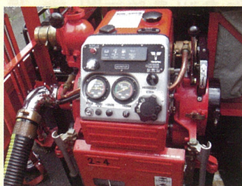
旧 小型動力ポンプ
