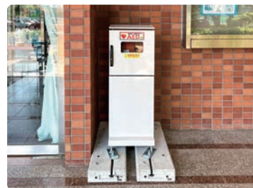
第1号公園体育館入り口に設置されたAED屋外収納ボックス
