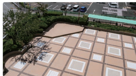
文化会館かえで広場の床タイルの張り替え工事を実施しました。
