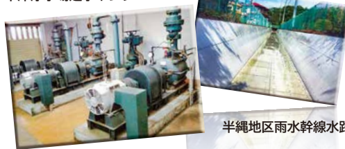
中津浄水場送水ポンプ
