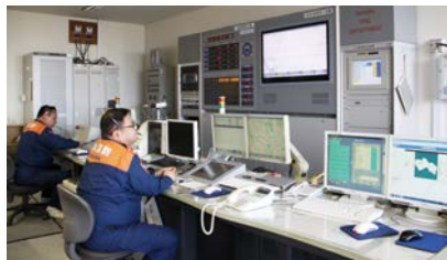
119番通報を受ける通信指令室
