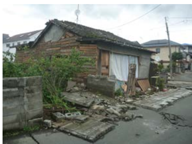
平成28年熊本地震で倒壊した 建物とブロック塀
