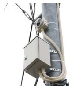
新設された防犯カメラ
