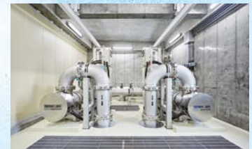
中津浄水場の紫外線照射設備
