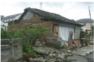
平成28年熊本地震で倒壊した建物とブロック塀
