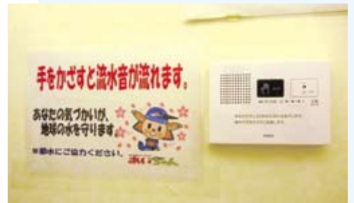
設置した擬音装置
