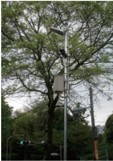
通学路に設置された防犯カメラ (半原地内)
