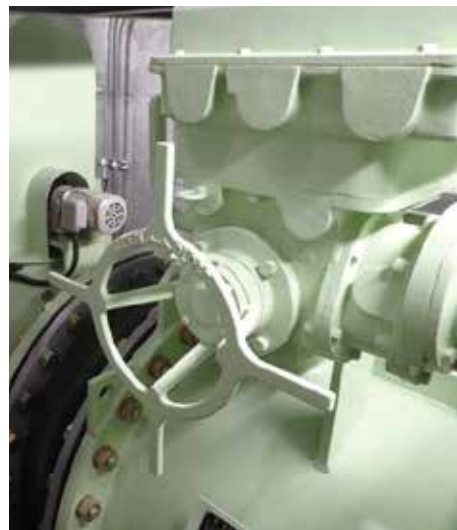
県で設置した早戸川小水力発電所内部
