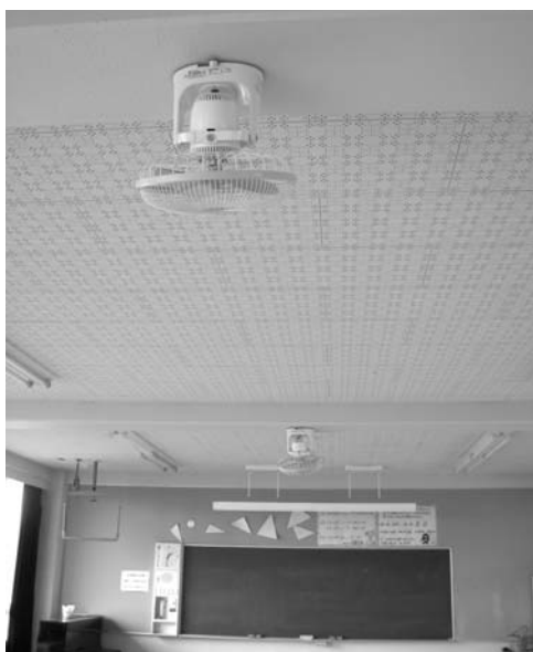
教室に設置された扇風機 (愛川東中学校)
