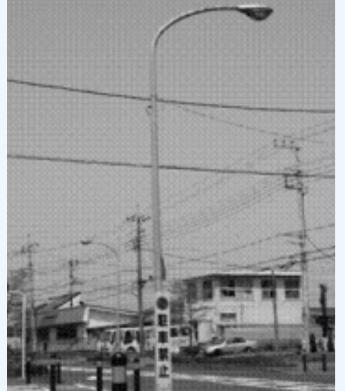
桜台・小沢線に設置されている道路照明灯
