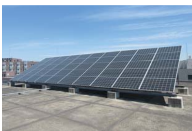
太陽光発電設備
