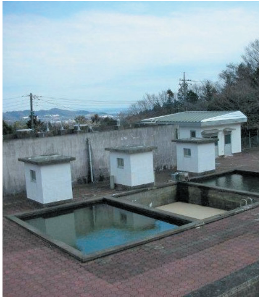
水道事業を支えている細野浄水場
