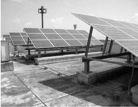
消防庁舎屋上の太陽光発電システム
