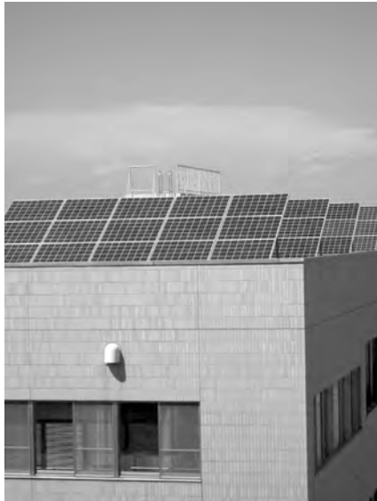
消防庁舎に設置している太陽光パネル
